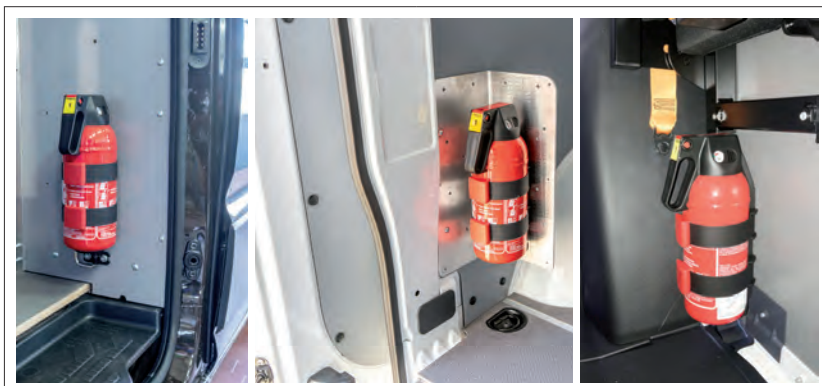
Figura 3: Estintore dietro la porta scorrevole del vano di carico e nella cabina di guida (a destra)
